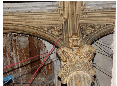
Magnifique poteau en bronze moulé soutenant la dalle du premier étage. Il a été dégagé par le propriétaire.
